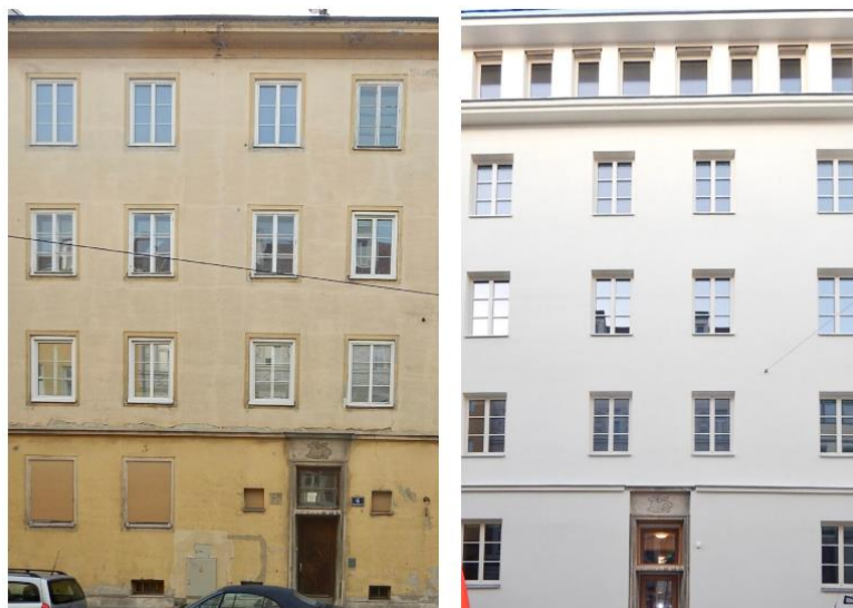
Supraetajare de Architektur Atelier Kiener în Darnaudgasse, Viena – imagine înainte / după reabilitare+supraetajare
